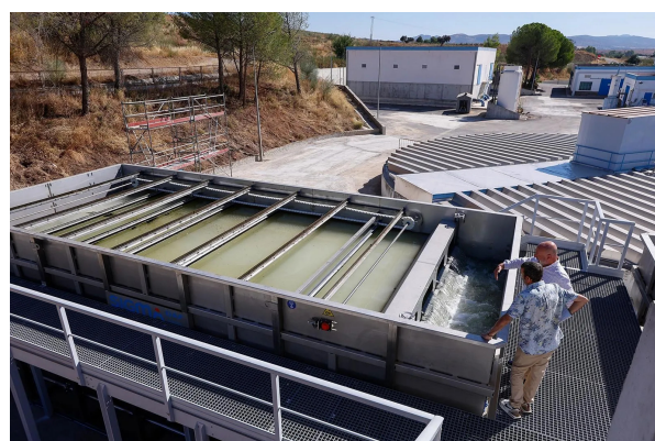
Foto 24: Instalaciones tratamiento de agua en Bélmez. Fuente: https://infoguadiato.com
