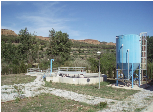
Foto 25: Vista general del decantador secundario y espesador de fangos de la EDAR de Alcudia de Guadix/Esfiliana. Fuente: CAPAyDR y http://www.aljibeconsultores.es/
