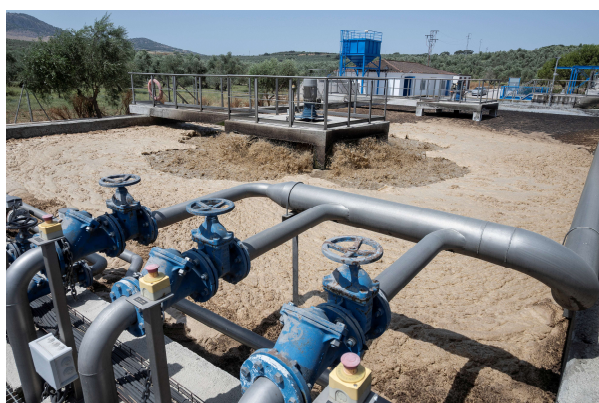
Foto 56: EDAR de Estepa. Fuente: https://www.estepa.es
