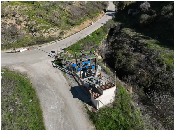
Foto 44: EDAR de Colmenar. Fuente: https://www.malaga.es
