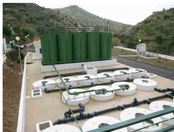
Foto 48: EDAR de Riogordo. Fuente: https://www.malaga.es
