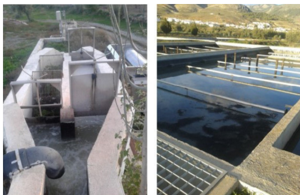
Foto 8: Entrada agua bruta (izqda.) y lechos de turba (drcha.) EDAR Laujar de Andarax. Fuente: Diputación de Almería
