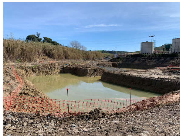
Foto 33: Proyecto adecuación EDAR Lucena del Puerto. Fuente: https://www.miteco.gob.es
