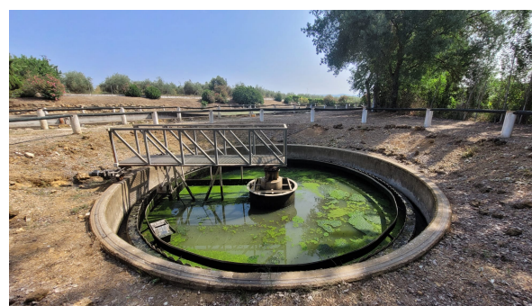
Foto 57: EDAR de La Puebla de los Infantes. Fuente: https://ayuntamientolapuebladelosinfantes.wordpress.com
